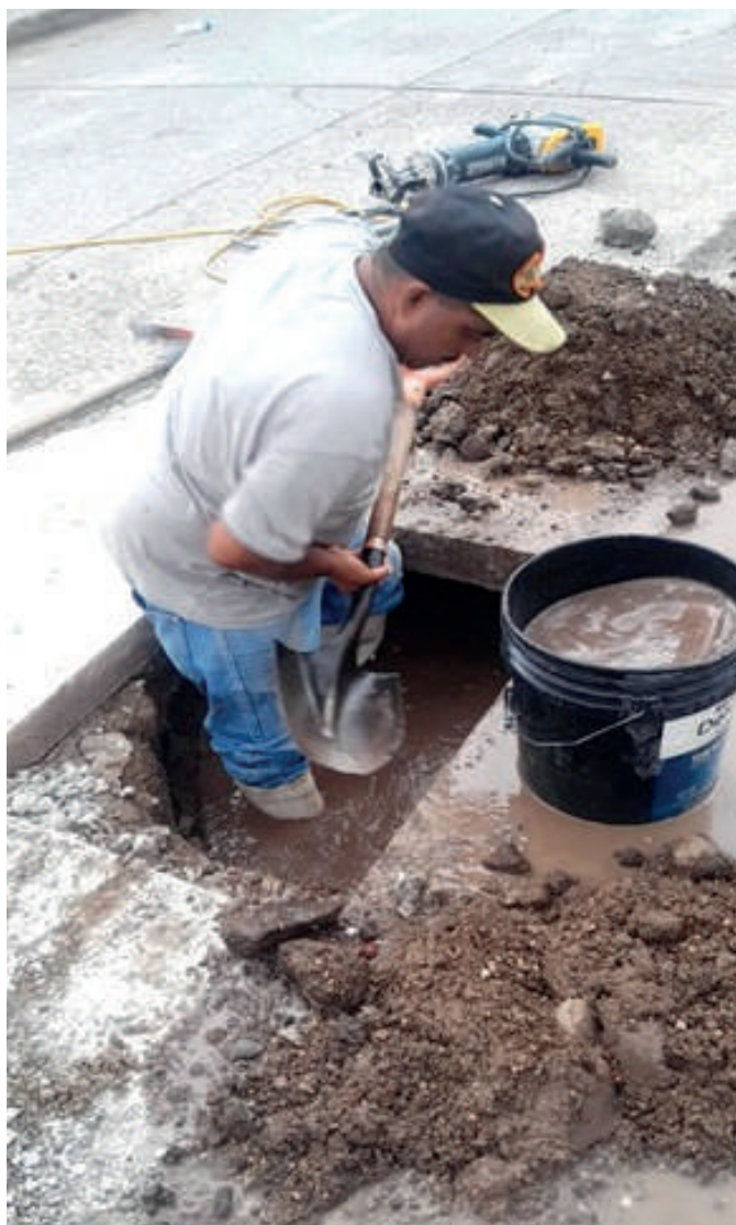
Se realizaron 148 inspecciones domiciliarias por consumos elevados y se atendieron 81 reportes de fugas en las líneas de agua potable.
